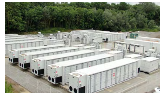
美国伊利诺伊 300MWh 项目
