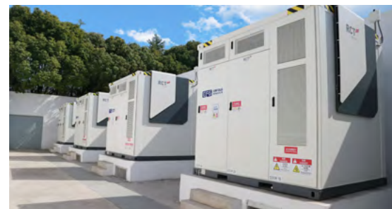
江苏 / 苏州 -2.99MW/5.96MWh
