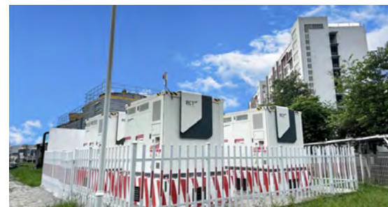
江苏 / 苏州 -2.99MW/5.96MWh
