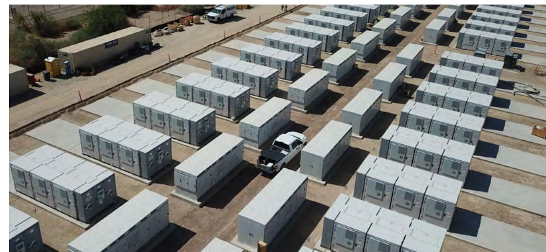
美国德克萨斯州 100MWh 项目
