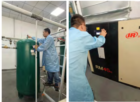
相城工厂空压机房压力容器异常现场处置
