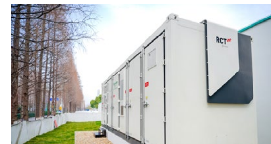
江苏 / 无锡 -600kW/1800kW 项目
