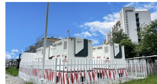
江苏 / 苏州 -2.99MW/5.96MWh
