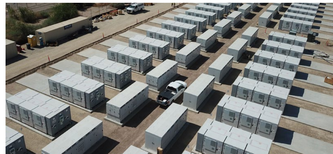
美国德克萨斯州 100MWh 项目
