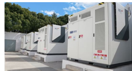
江苏 / 苏州 -2.99MW/5.96MWh
