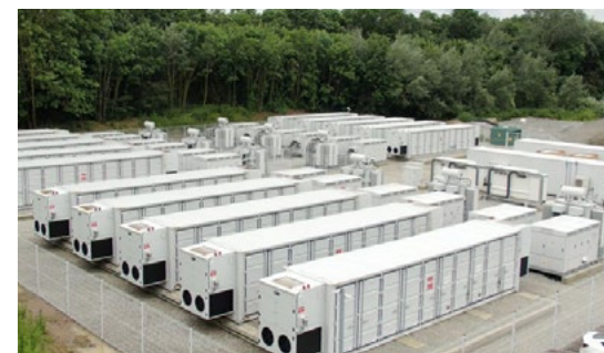
美国伊利诺伊 300MWh 项目
