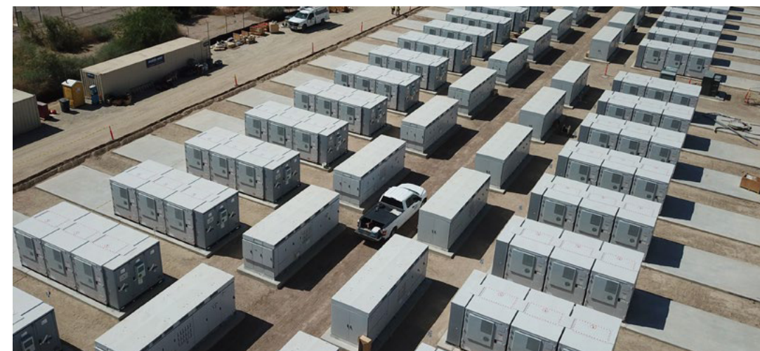
美国德克萨斯州 100MWh 项目
