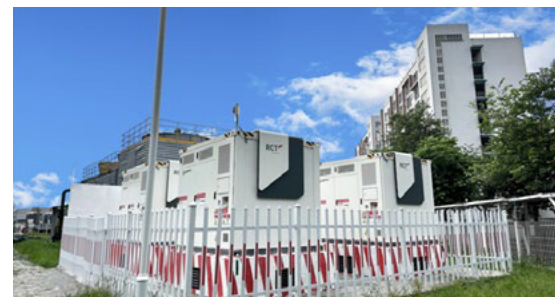
江苏 / 苏州 -2.99MW/5.96MWh
