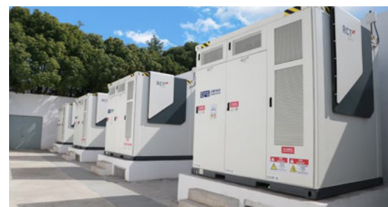
江苏 / 苏州 -2.99MW/5.96MWh
