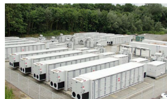
美国伊利诺伊 300MWh 项目
