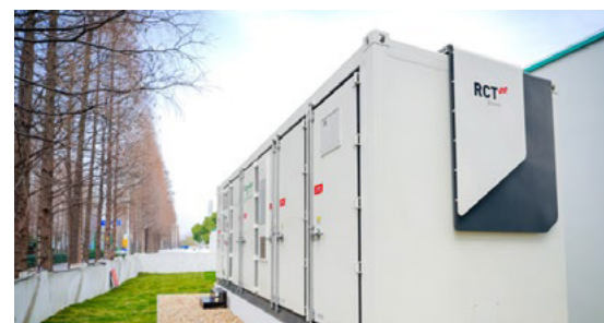
江苏 / 无锡 -600kW/1800kW 项目
